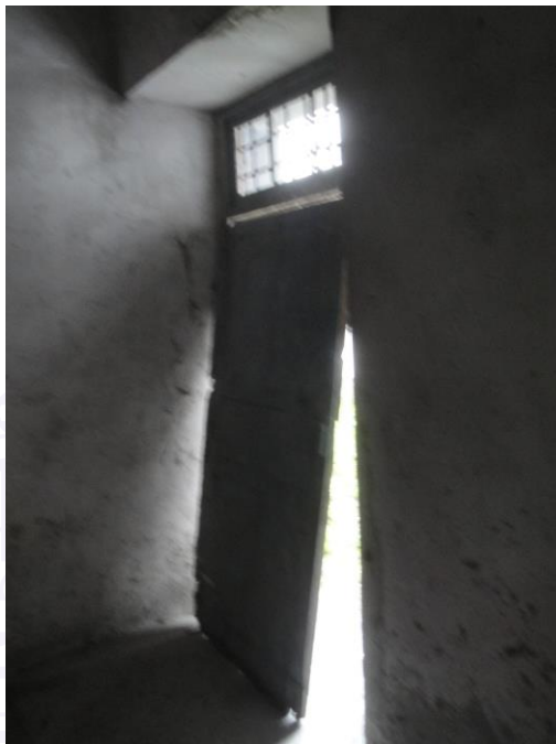
Puerta a sustituir(Pta baja)
