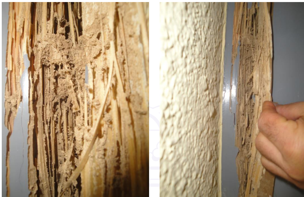
Ataque termitas a marcos de ventanas
