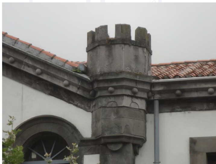
Torrecilla con filtraciones
